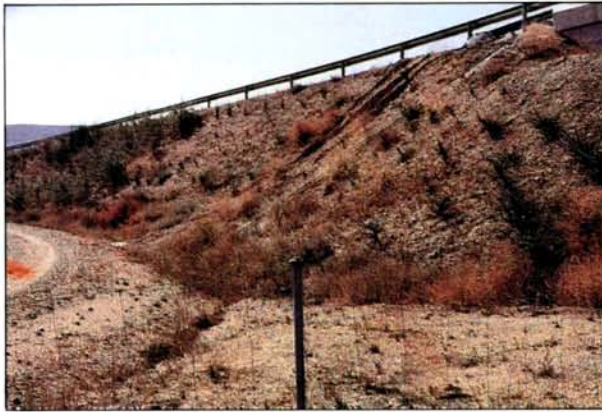
Iniciación de cárcavas en terraplén por falta de cobertura vegetal. N-620 (Valladolid Burgos).
