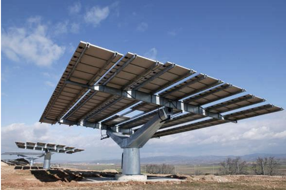
Imagen 10: Paneles fotovoltaicos sustentados por un seguidor de dos ejes
