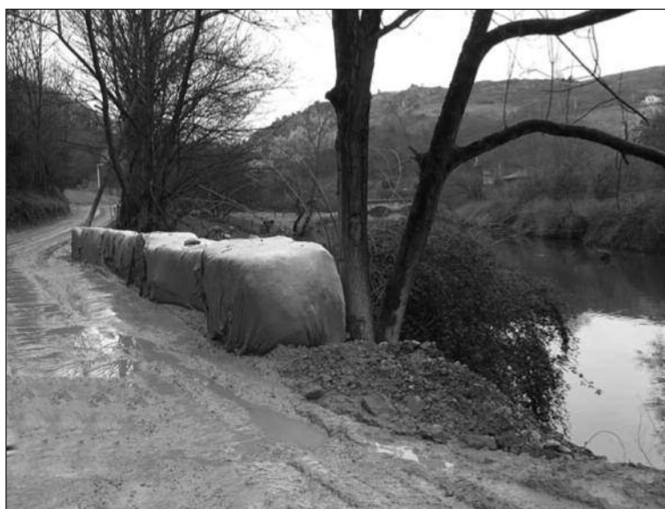
Figura 9.13. Alpacas de palla no río Nora (Asturias) para evitar a chegada parcial de sedimentos das obras dunha autopista (foto: J. Navarro)
