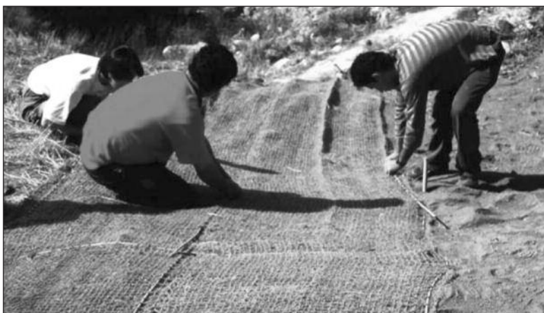
Figura 9.3. Instalación dunha rede de coco sobre terra vexetal nunha cárcava en Palencia (Navarro et al., 1997)
