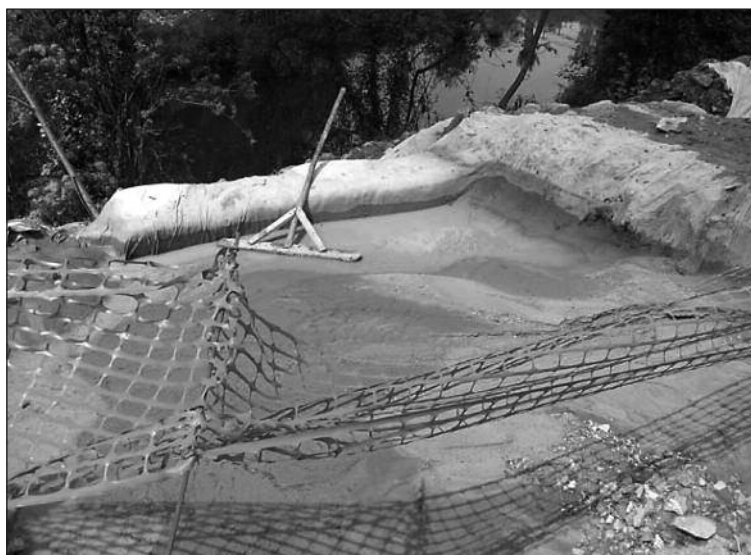
Figura 9.14. Balsa de decantación con sedimentos retidos pola construción dun viaduto no río Nora (Asturias) (foto: J. Navarro)
