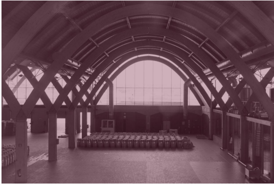
Fig 62. Fotografía del interior de la sala de distribución de la bodega Protos. (Fuente: Elaboración propia).
