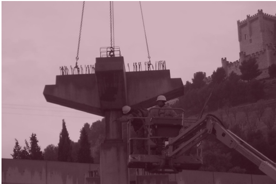
Fig 68. Fotografía en obra de la colocación de los ábacos de hormigón prefabricado de la bodega Protos. (Fuente: Elaboración propia a partir de la documentación facilitada por Rosa Bellido Pla).
