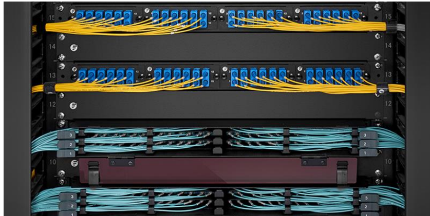
Figura 19: Sistema de cableado en rack.
