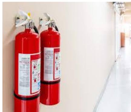
figura 9c: Extintores de mano.
