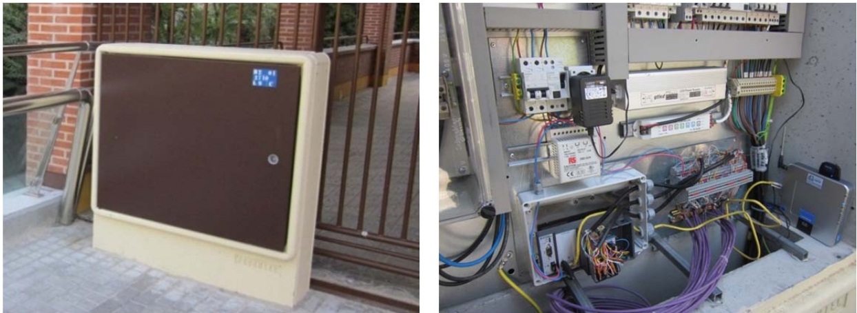
Figura 3-77. Sistema de medida instalado en el sistema eléctrico.
