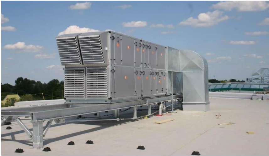
Ilustración 30. Unidad exterior AHU [72]
