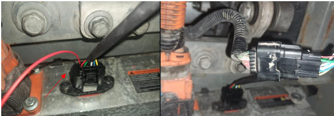
Figura 46. Conexión EPOS4-Yazaki hembra-Yazaki macho-Yazaki hembra- Batería, cable rojo conectado a la seta de emergencia.
