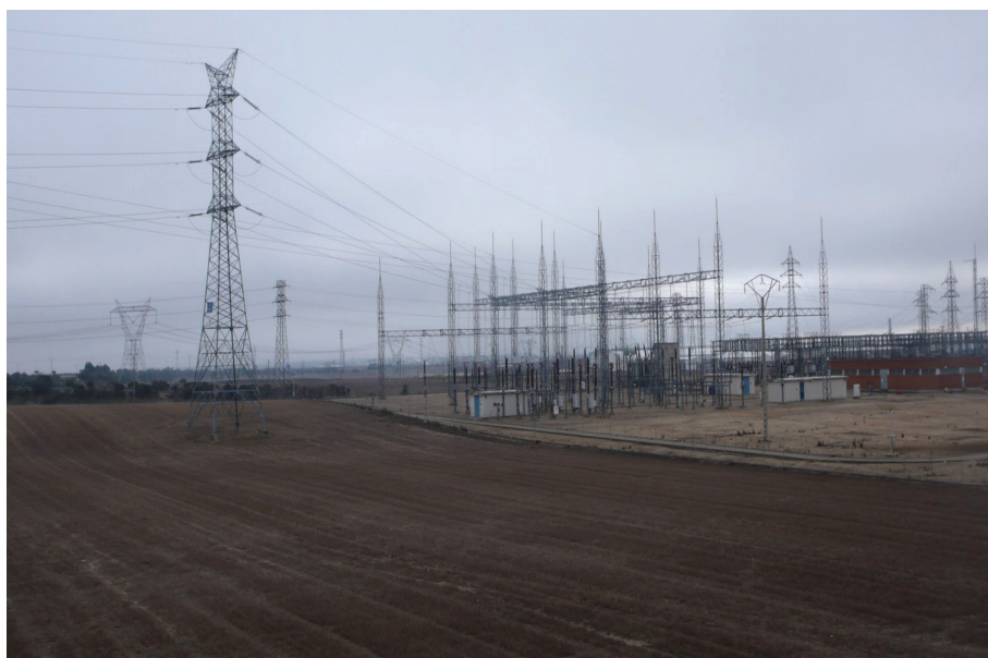
Figura 19. Redes de alta tensión y parque de transformación en la provincia de Valladolid. Fuente: Fotografía del autor.
