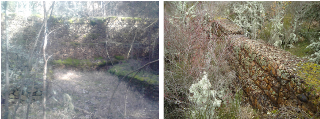
Figura 6.2. Dique 28 con el disipador de energía totalmente colmatado (izquierda) y dique 34 que aún no se encuentra totalmente aterrado (derecha).
