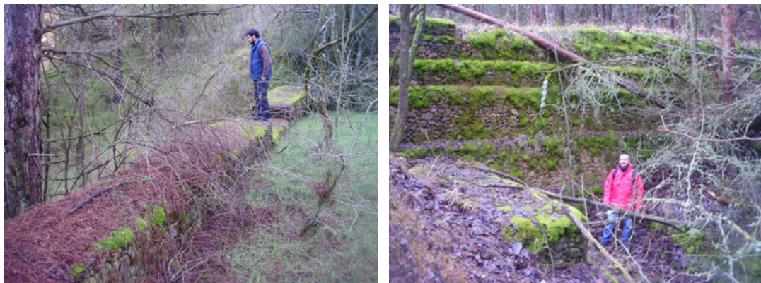
Figura 6.3. Dique 38 con problemas de desestribado (izquierda) y dique 23 el cual presenta el mayor paramento de toda la muestra (derecha).
