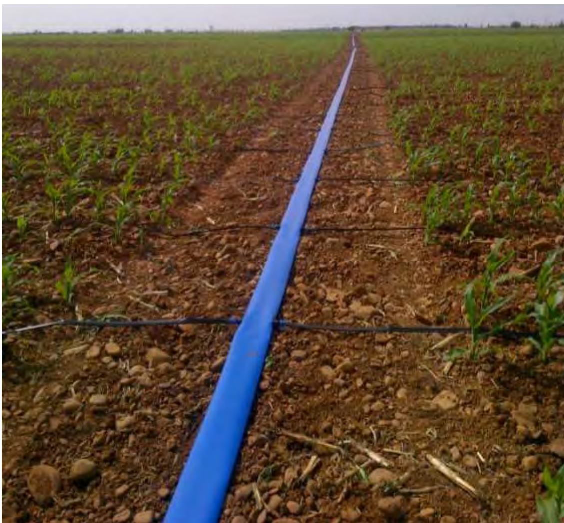
Figura II. 20. Instalación de riego localizado mediante cinta de goteo en parcela de maíz.
