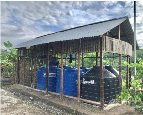
Foto 3.- Sistema de Agua del Recinto: tanques principales de abastecimiento
