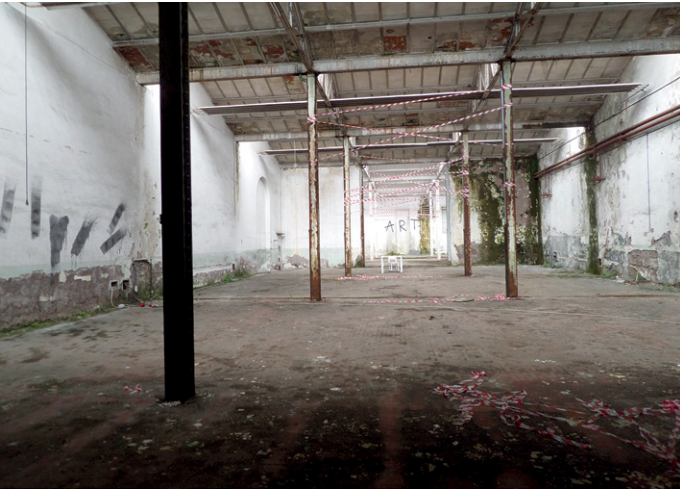
Figura 4. Precariedad de los edificios del cuartel Guido Reni. Fuente: F. Camerín (2022).
