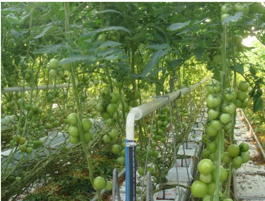
Figura 21: Sistema de calefacción en invernadero Fuente: invernaderosima.com
