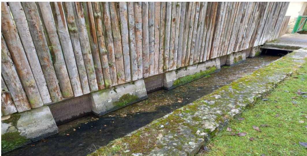
Figura 18: Rejillas de entrada de agua a la sala exterior de alevinaje.
