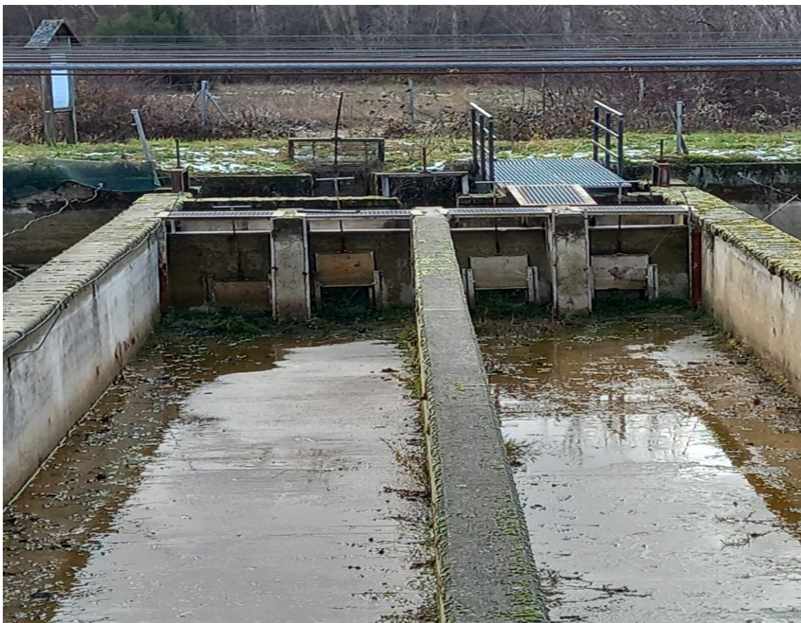
Figura 37: Rejillas perforadas de la batería A.
