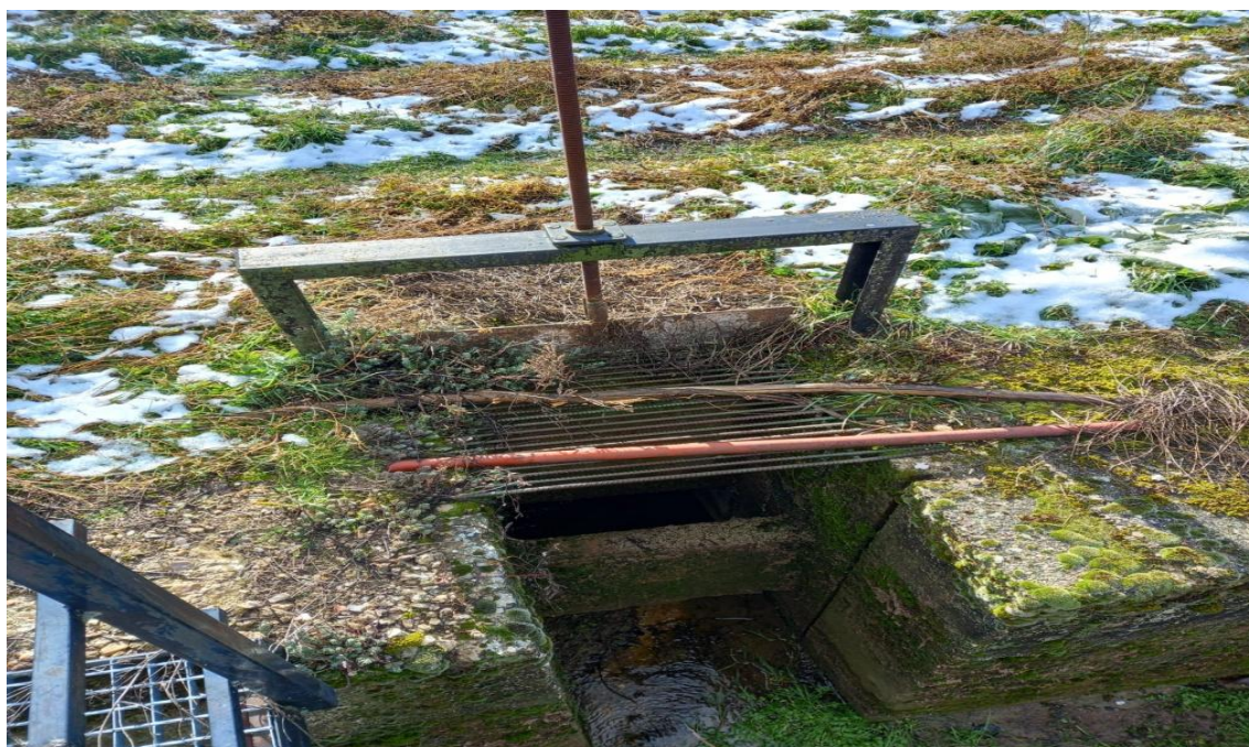
Figura 39: Tajadera de salida de agua del estanque.
