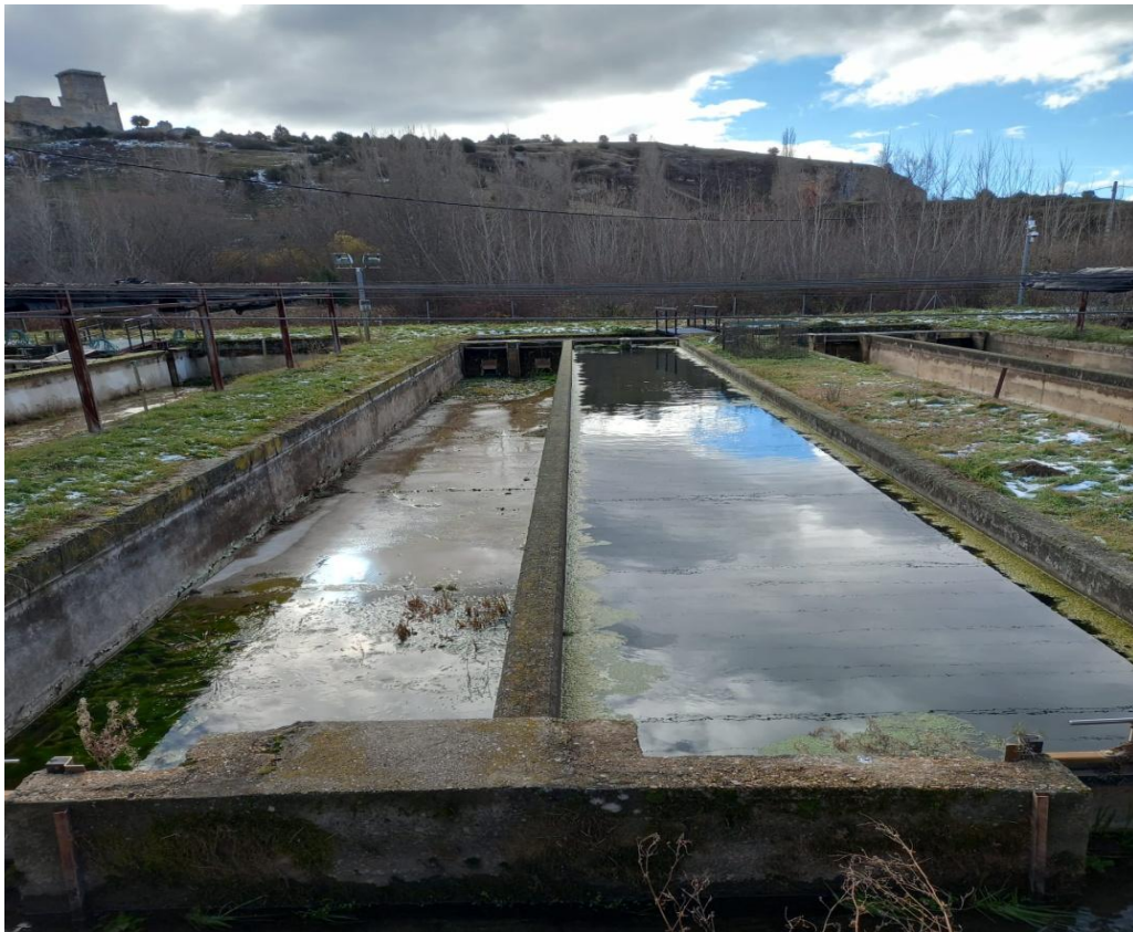
Figura 43: Primer grupo de estanques de la batería B.
