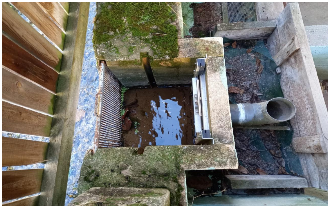
Figura 30: Entrada de agua a las pilas de alevinaje, compuerta de polietileno con salida a tubo de diámetro nominal 200mm.
