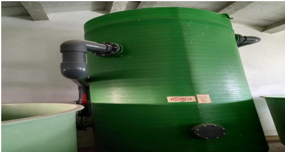
Figura 20: Tanque de poliéster.
