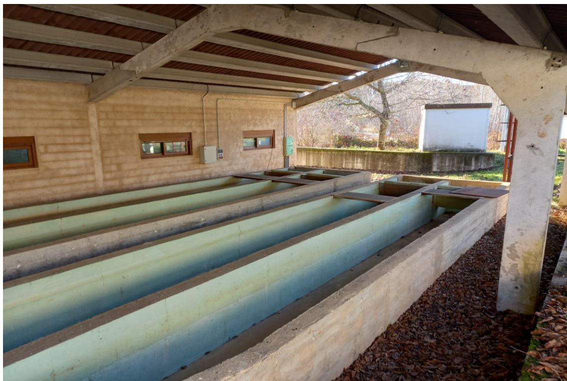
Figura 28: Vista general de las pilas de hormigón de la sala de alevinaje exterior.
