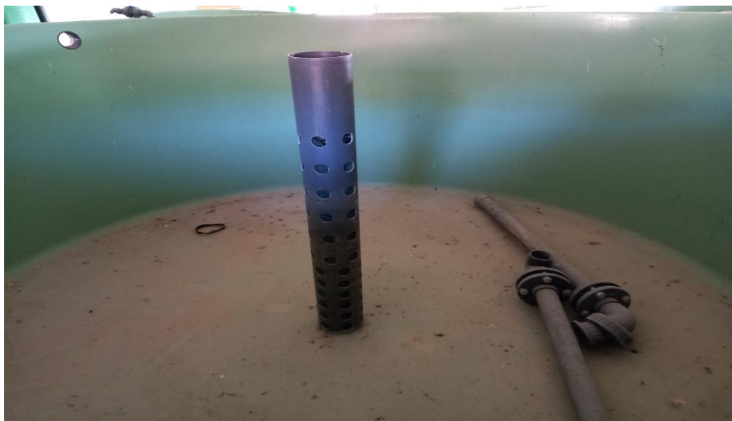
Figura 26: Desagüe central agujerado de PVC, para filtrar y sacar el agua de las pilas.
