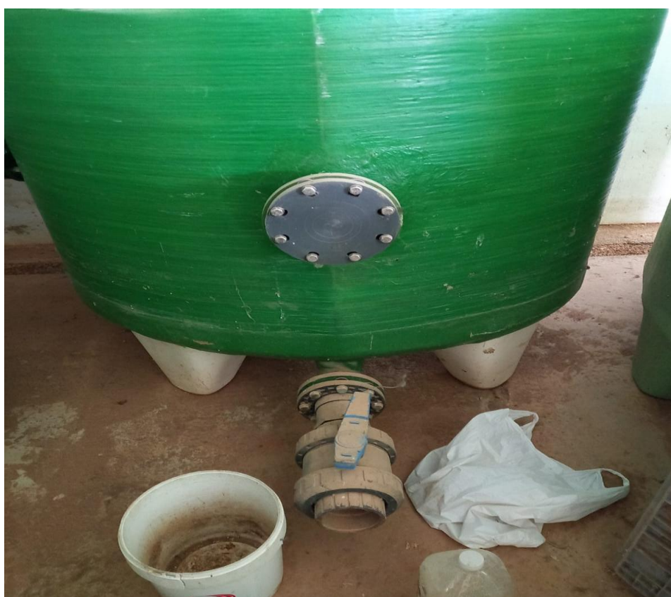
Figura 22: Toma accesoria y desagüe de fondo con válvula de esfera.
