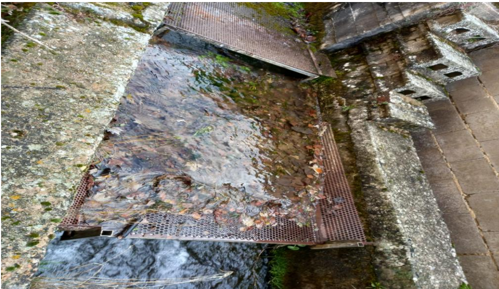
Figura 15: Rejillas de desbaste para la retirada de hojas y grandes sólidos.
