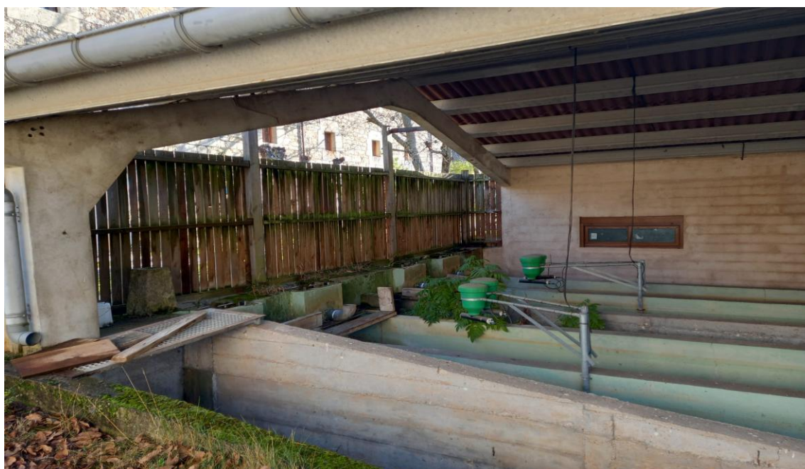
Figura 29: Vista de la entrada del agua a las pilas de alevinaje.
