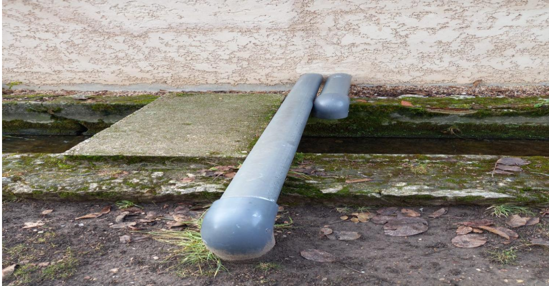
Figura 17: Tubos de entrada del agua a la nave de alevinaje interior.
