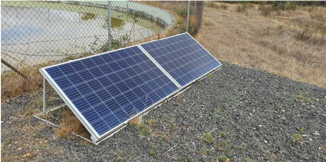
Figura 22: Módulos instalados en tierra.
