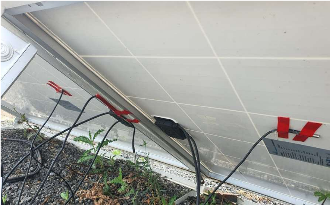
Figura 13: Panel instalado en tierra. Parte trasera. Detalle de ubicación de las tres sondas de temperatura.
