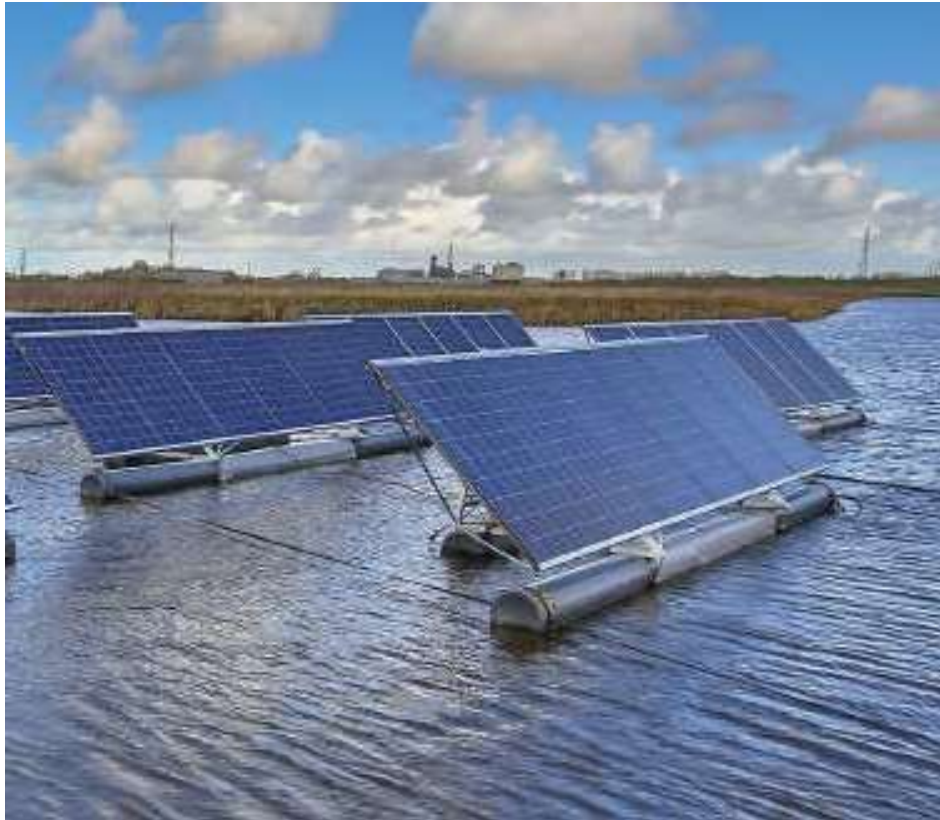
Figura 6: Paneles fotovoltaicos instalados en flotación. Fuente: [9]
