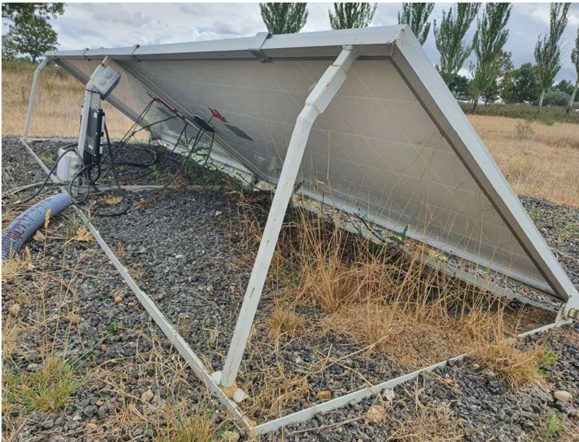
Figura 23: Detalle de la estructura de soporte de los paneles.
