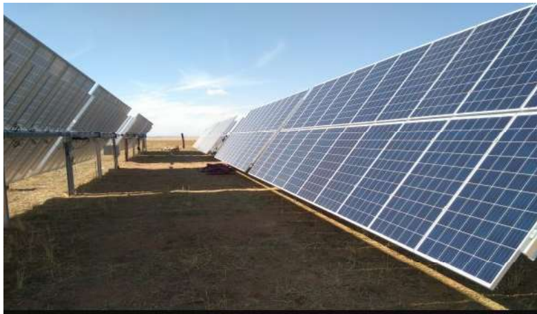
Figura 4: Paneles fotovoltaicos instalados en tierra. Fuente: [7]
