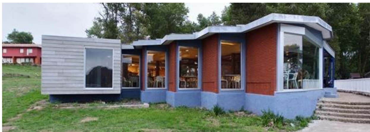
Ilustración 75; Estado actual del muro norte aserrado. Fuente: https://unfuturoparaperlora.blogspot.com/
