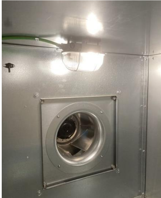
Figura 8: Ventilador de impulsión
