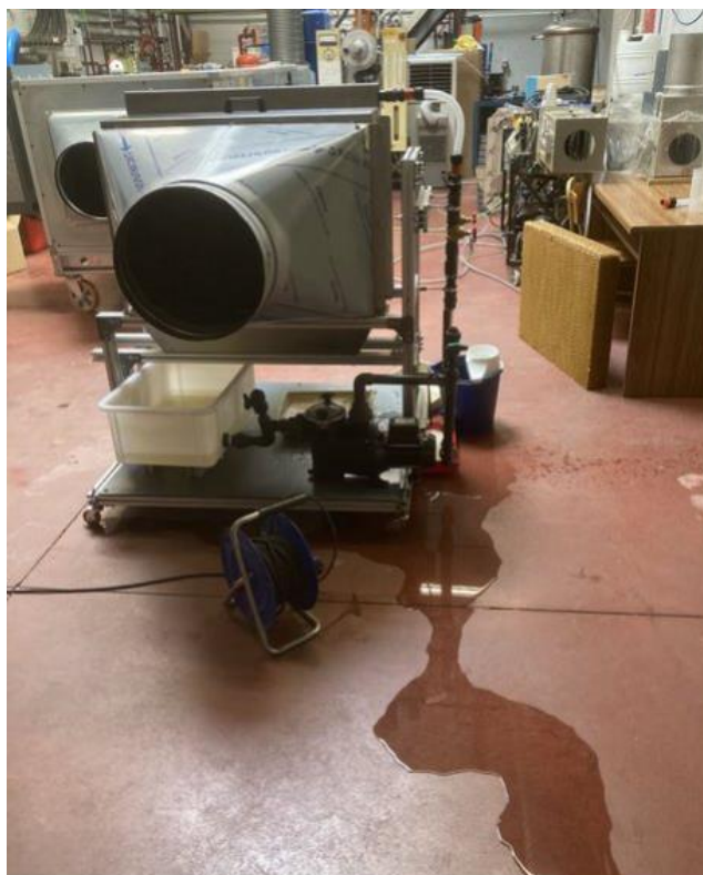
Figura 23: Fuga en el equipo al arrancar la bomba
