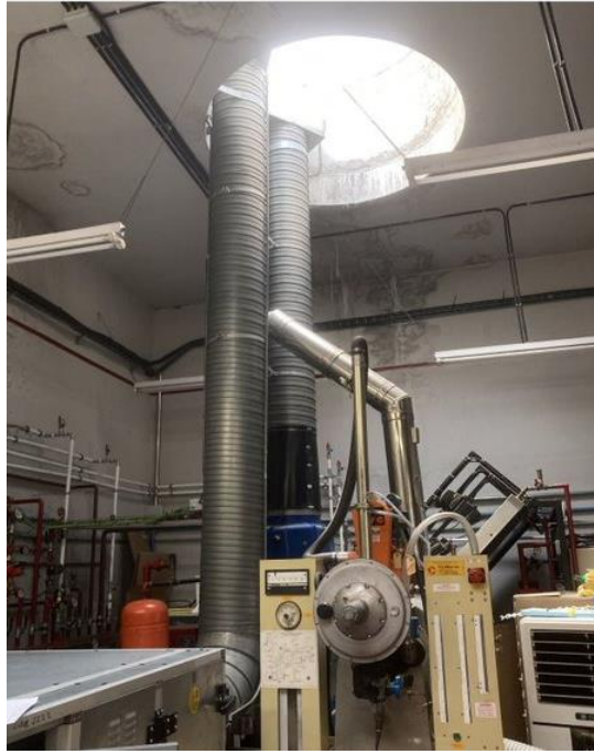
Figura 14: Toma de aire de la UTA al exterior
