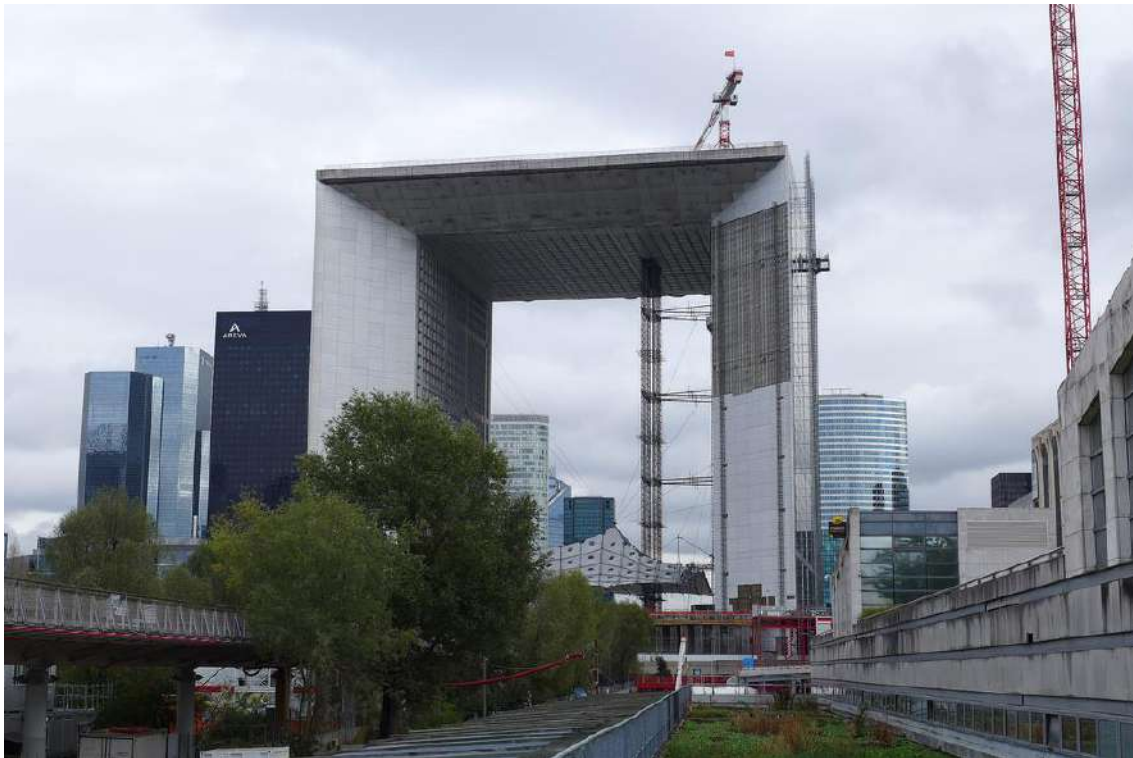
Obras Fase 1. Desmontaje fachada original. Imagen google maps https://www.google.com/maps/place/Arco+de+la+D%C3%A9fense (consultado el 01 de octubre de 2016)
