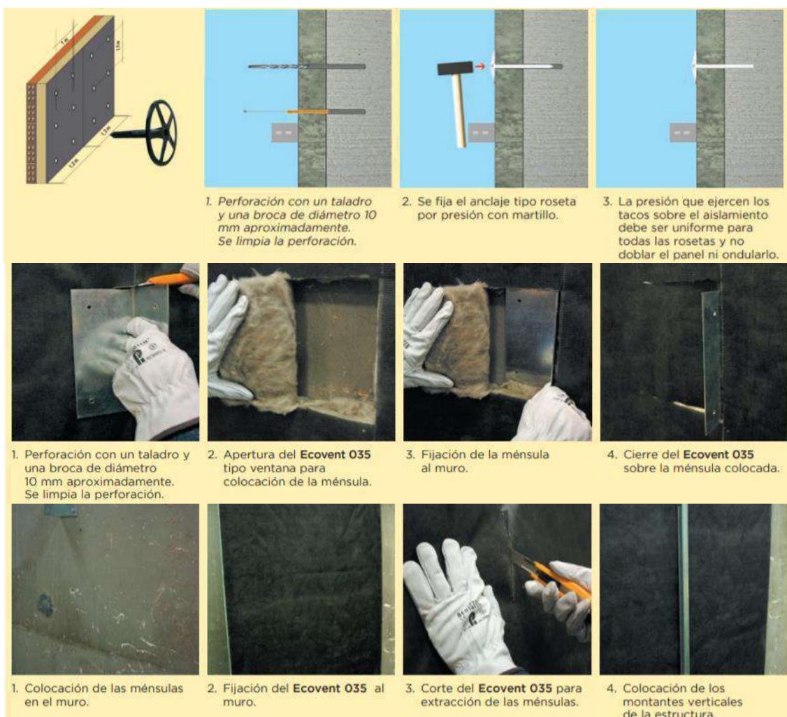
Figura 4.35. Ejemplo de fijación mecánica del aislamiento mediante tacos seta (arriba). Ejemplo de instalación de aislamiento semirrígido antes de fijar las ménsulas al soporte (centro). Ejemplo de instalación de aislamiento semirrígido después de fijar las ménsulas al soporte (abajo). Catálogo Isover 2019
