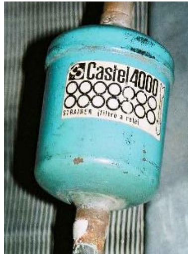
2.42 Filtro deshidratador de una bomba de calor
