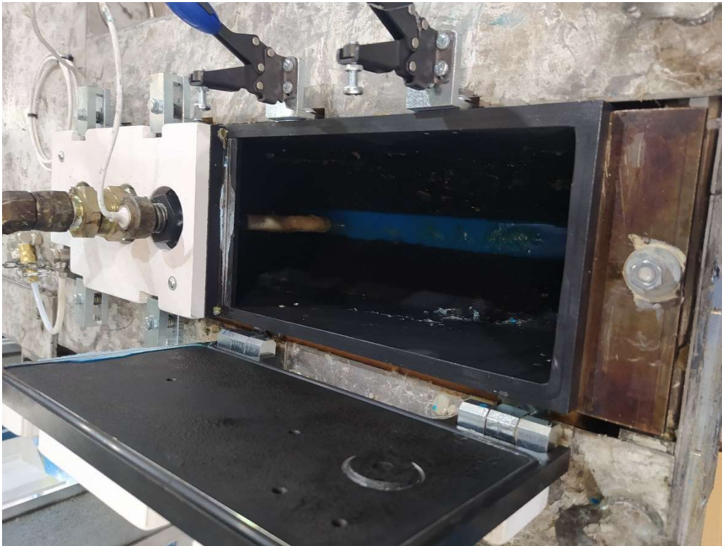
Ilustración 2.5.- Tolva o depósito de adhesivo. El producto azul del interior es una cera para limpieza. Fuente: Elaboración propia
