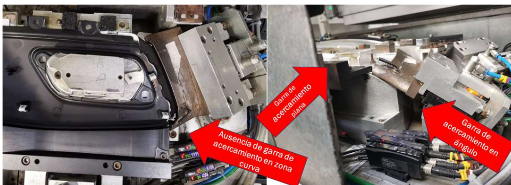
Ilustración 5.3.- Deficiente solución técnica para el rebordeo en zona poste A. Fuente: Elaboración propia
