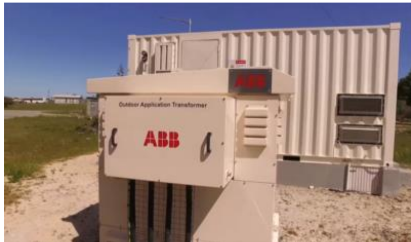
Figura 5.27: Imagen tomada de una batería de ABB.
