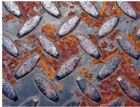
Figura 3: Ejemplo de corrosión selectiva. [5]
