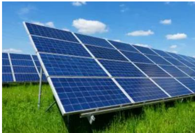
Imagen 9: Panel solar fotovoltaico
