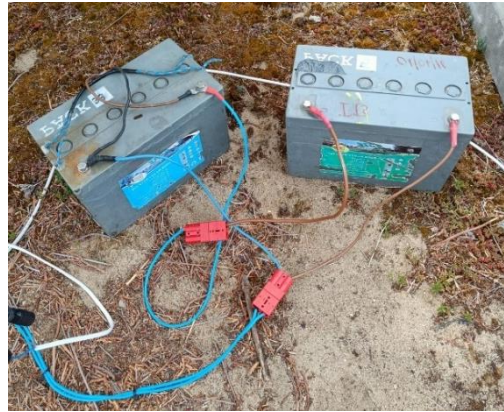
Ilustración 109. Baterías empleadas y su conexión en serie
