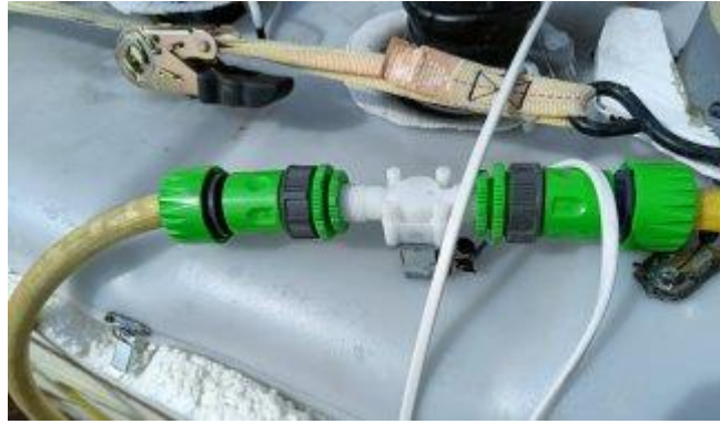
Ilustración 25. Electroválvula que regula el relleno con agua
