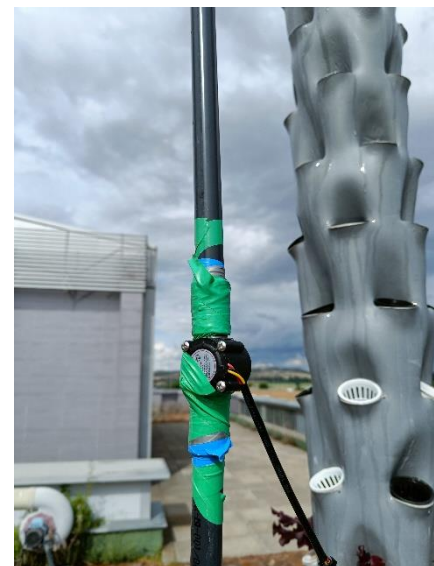
Ilustración 60. Caudalímetro YF-S201 instalado
