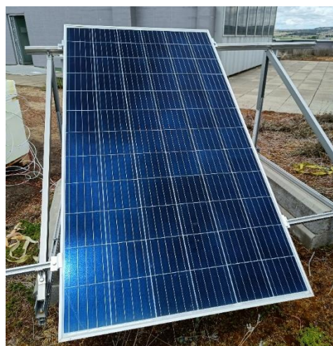
Ilustración 98. Panel solar instalado
