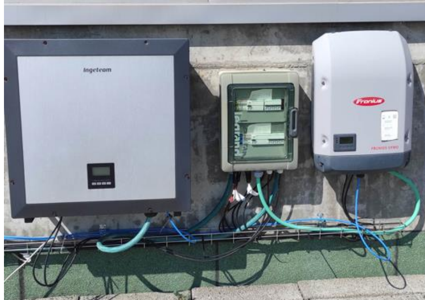
Figura 9: Inversores en funcionamiento en la estación solar fotovoltaica. Fuente: Elaboración propia.
