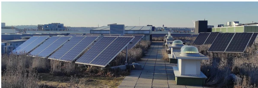
Figura 6: Planta fotovoltaica edificio Lucia. Fuente: Elaboración propia.
