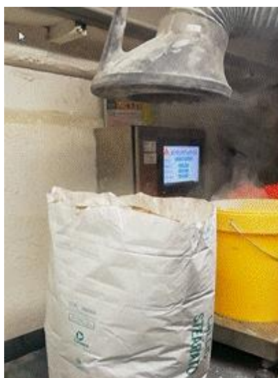
Figura 11. Campana de aspiración
