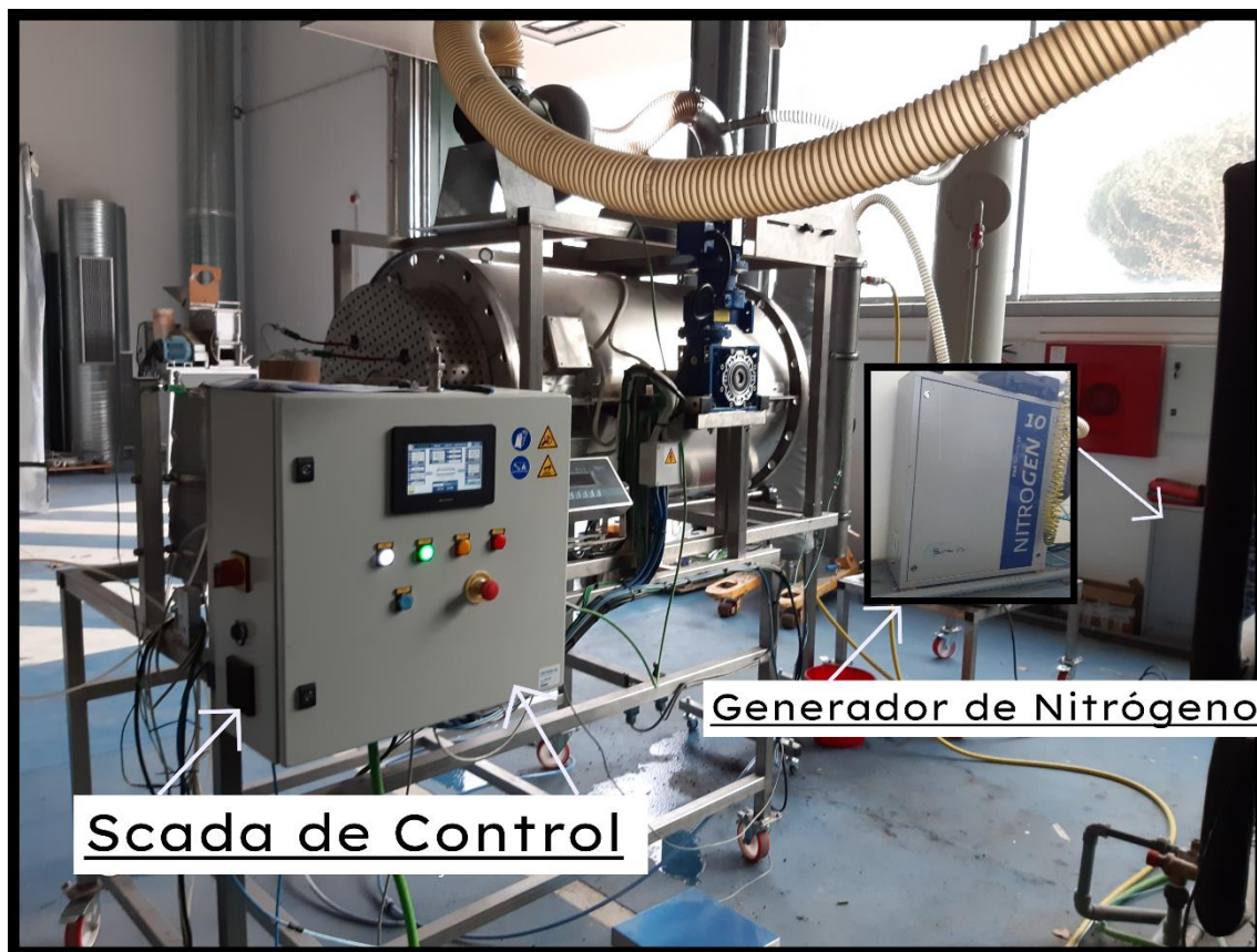
Ilustración 6: Equipos de la planta de pirólisis (Elaboración propia).
