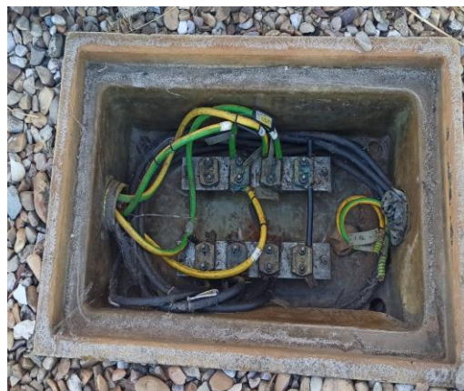
Figura 14: Puesta a tierra mecánica de las canalizaciones aéreas
