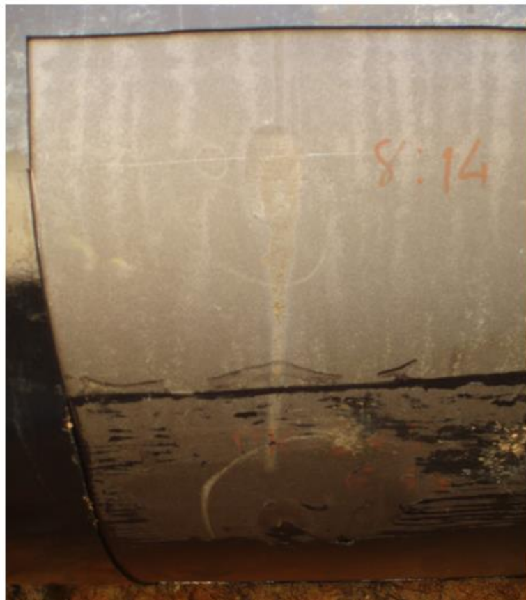
Figura 36: Daño en la integridad del gasoducto
