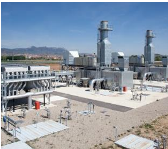
Figura 5: Estación de compresión (Haro)
