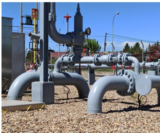
Figura 13: Canalización aérea protegida con pintura y puesta a tierra
