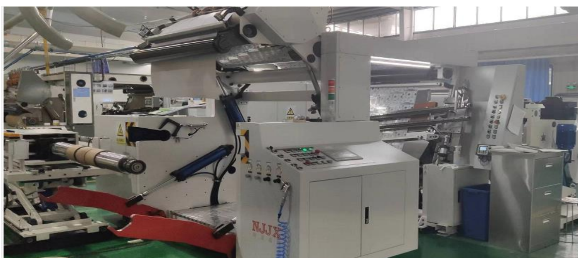
Figura 9. instalación de corte
