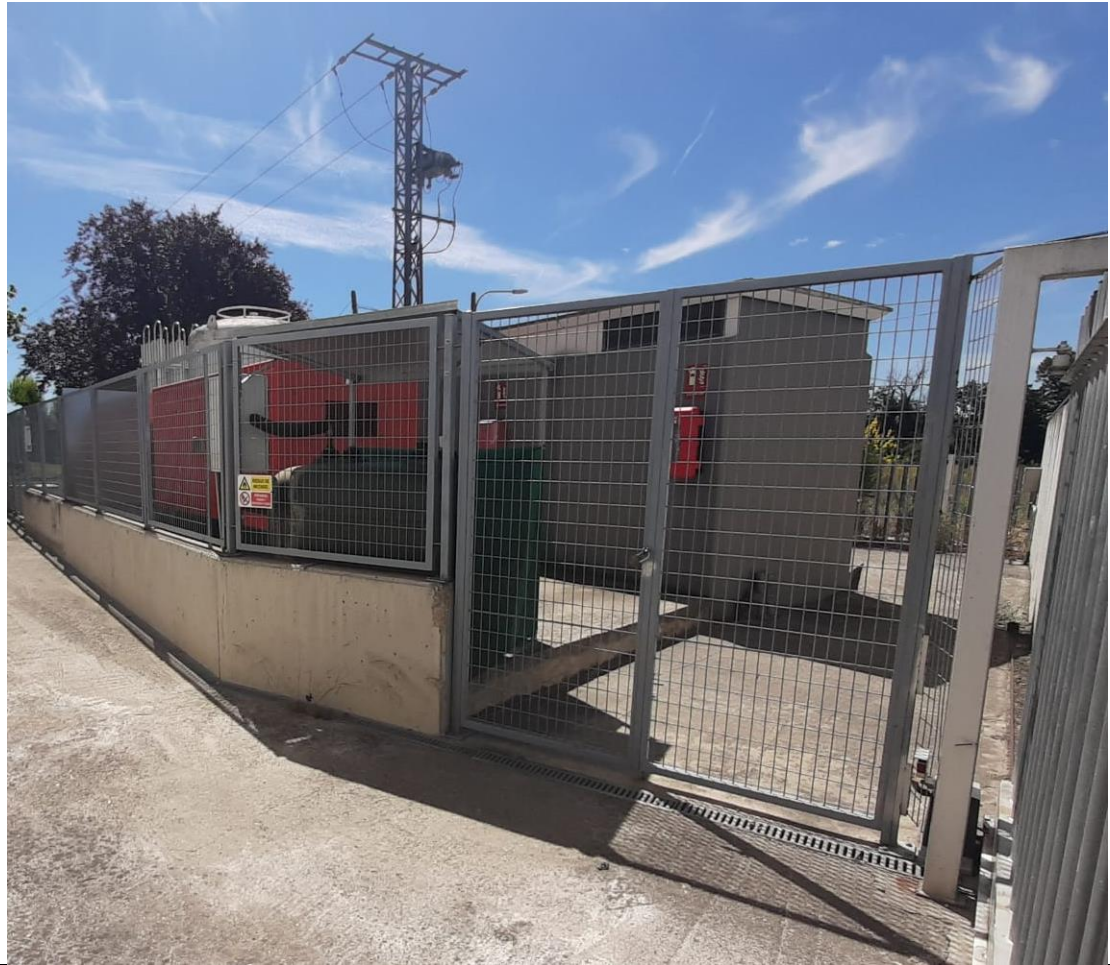
Figura 10: Centro de transformación del HBM, situado en un recinto cerrado y con señalización que advierte de riesgo eléctrico.
