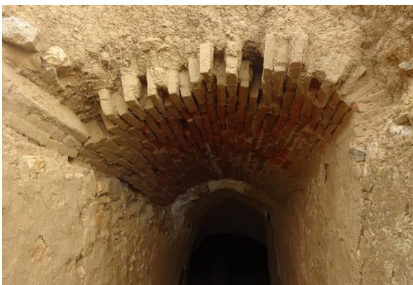
Fig. 3.10 Cañón de acceso con bóveda excavada – Jové Sandoval, F., Bodegas históricas de Fuensaldaña; tradición y futuro vitivinícola , Cátedra JdV, 2023
