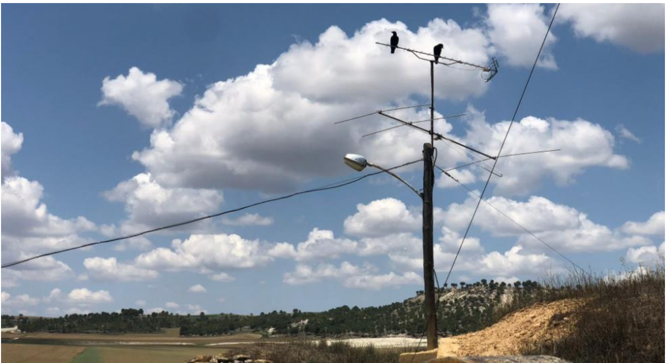
Fig. 4.66 Foto de poste de luz – Elaboración propia.
