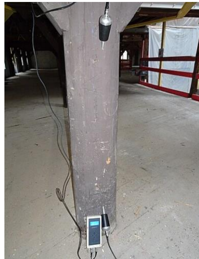
Ilustración 9: Medición indirecta en estructura de madera. Almacenes generales de París. Fuente: https://shorturl.at/ekquM
