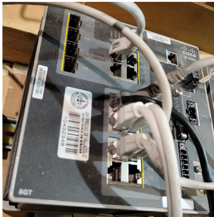
Figura 3.12: Conexiones en el router CISCO
