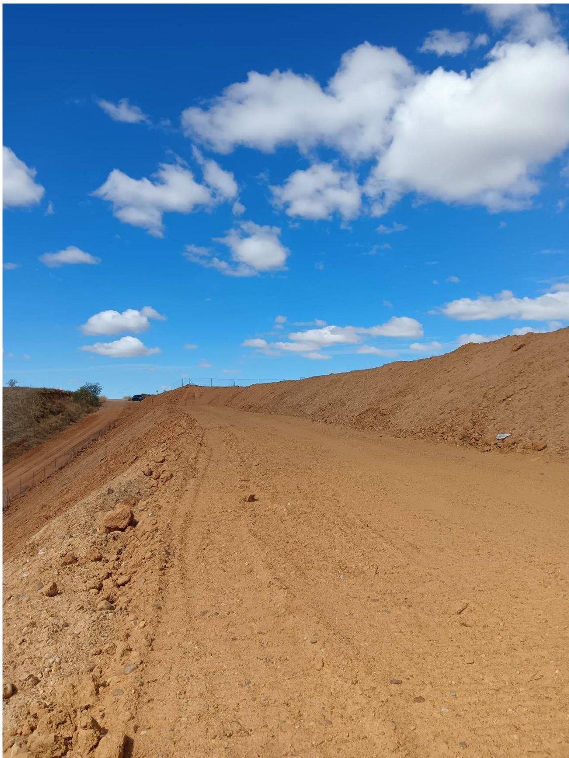
Figura 8. Vista hacia el noroeste del camino creado y del talud oeste. Fuente: Elaboración propia, 26/09/2022.
