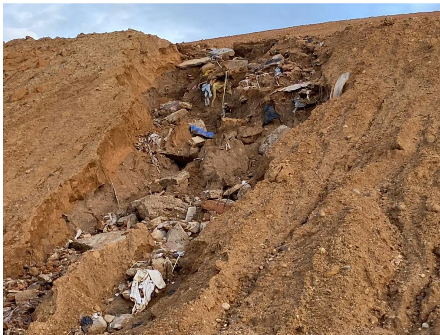
Figura 5. Fotografía de los afloramientos de escombros en el talud sur tras las intensas lluvias de enero de 2023. Fuente: Elaboración propia.
