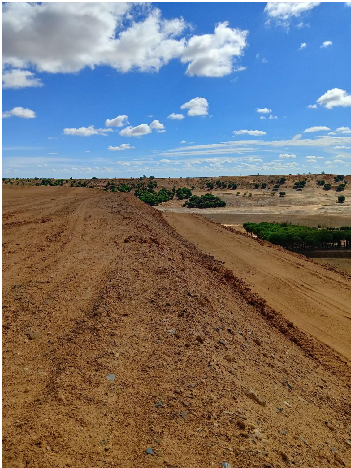
Figura 6. Pista creada durante el movimiento de tierras y creación de taludes, que conecta la plataforma superior y la inferior. Fuente: Elaboración propia, 26/09/2022.
