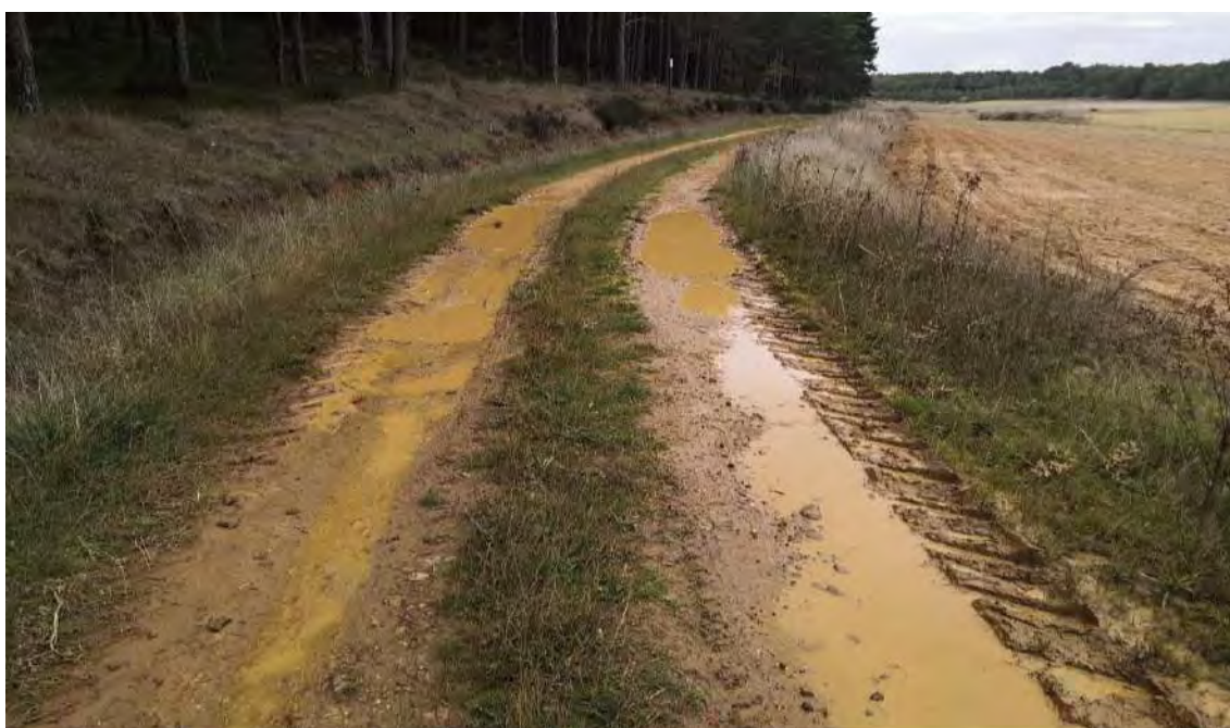
Figura 26. Camino encharcado por compactación del terreno (Fuente: propia).
