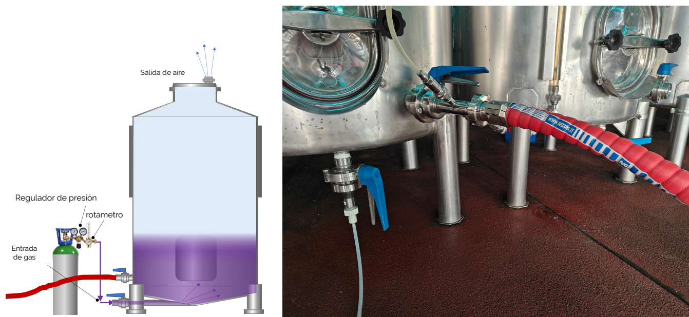
Fig. 13.7: Conexión recomendada para la inertización de mangueras y depósitos con dos válvulas
