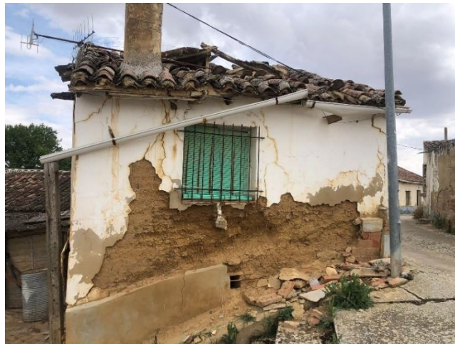
Figura 16 Casa en ruinas en Grajal de Campos
