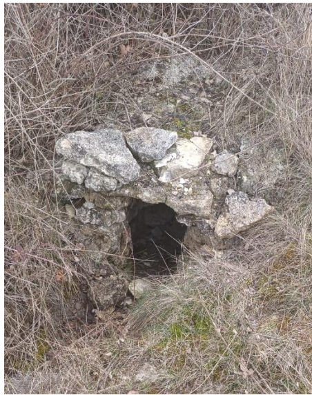
Fotografía de la fuente de Caravante antes de ser reparada. Fotografía propia.
