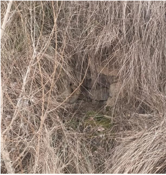
Fotografía de la fuente el Volantino antes de ser reparada. Fotografía propia.
