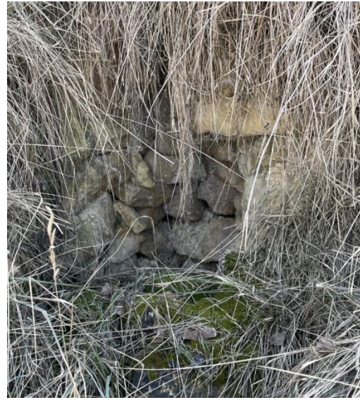
Fotografía de la fuente el Volantino antes de ser reparada. Fotografía propia.
