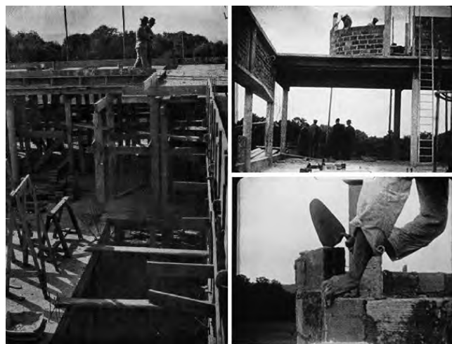
Figura 7. Fotografía del hueco de la rampa de la Villa Savoye durante las obras, de junio de 1929, probablemente de Sigfried Giedion. Fuente: Giedion, S. (1930). Le Corbusier et l'architecture contemporaine. Cahiers d'Art V , (4), p. 211. Fotogramas de la filmación amateur de Ernest Weissmann de la obra de la Villa Savoye , de julio de 1929. Fuente: se remite a la publicación de Veronique Boone (2).
