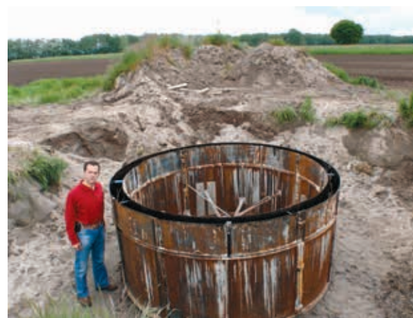
Figura 7. Pozo de gran diámetro para captación-depósito de agua
