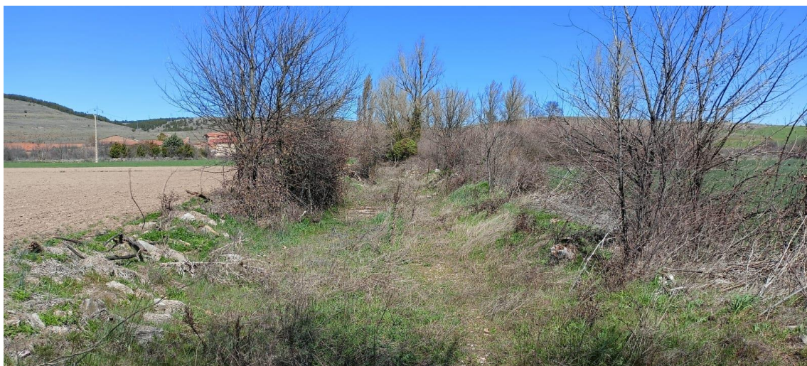
Figura 2. Estado actual del camino de acceso, donde se puede observar la inexistencia de las cunetas
