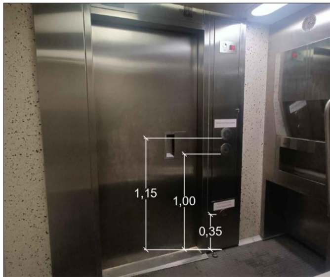
Foto 65 y 66: Medidas del espacio higiénico a la salida de Campo Grande, Valladolid. Fotografías de la autora.
