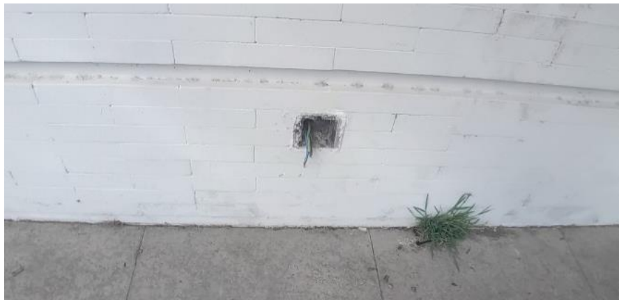
Foto 99: Zona con enchufes en mal estado y cableado inseguro. Campo Grande, Valladolid. Fotografía de la autora.
