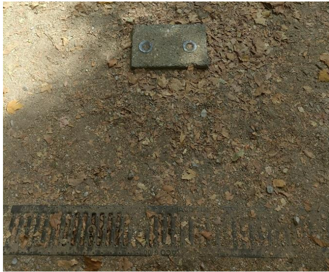
Foto 86: Apoyo de la puerta de entrada colocado en el medio del acceso, generando un resalto en el suelo. Campo Grande, Valladolid. FA.
