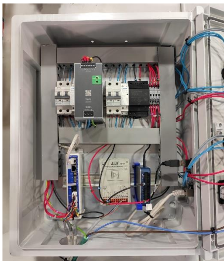
Figura 42 Cuadro eléctrico con componentes [Imagen Propia]
