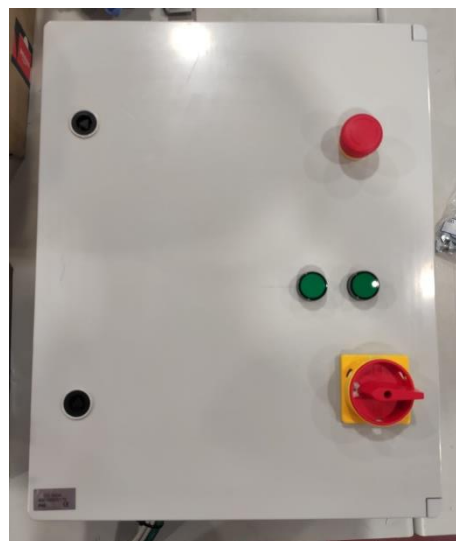
Figura 43 Cuadro eléctrico vista externa [Imagen propia]
