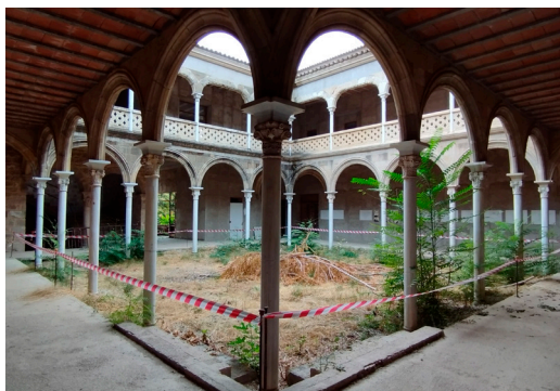
Figura 6. Estado actual del patio del Palacio de Francisco de los Cobos, Úbeda (Jaén).
