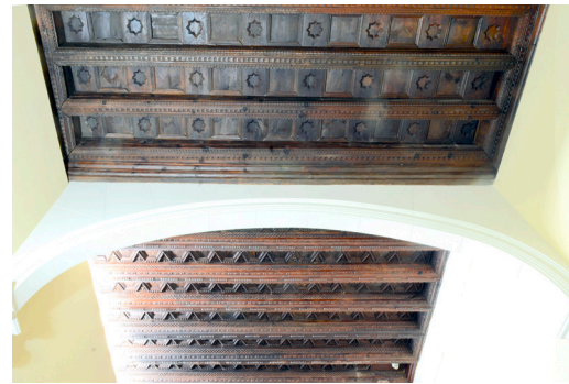
Figura 9. Sucesión de forjados en las piezas aledañas al ángulo suroccidental del patio. Palacio Real de Valladolid. Fuente: Joaquín García Nistal.
