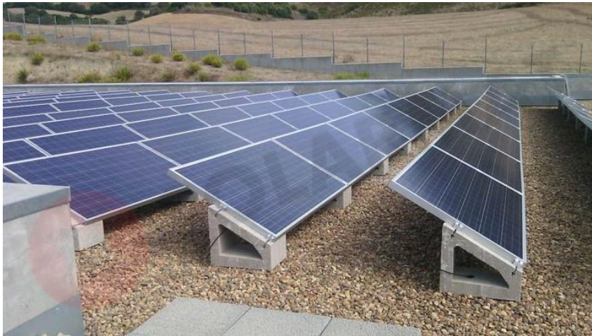
Figura 56: Soportes para placas fotovoltaicas
