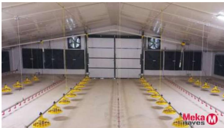
Figura 13. Disposición en la nave
