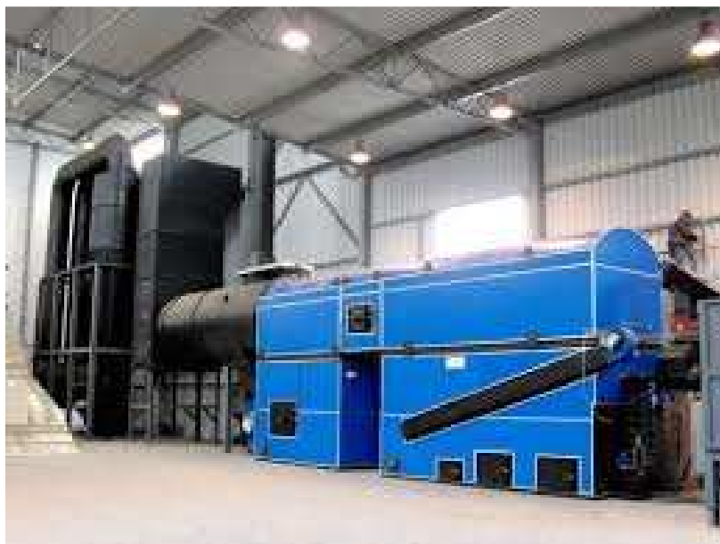
Figura 18: Caldera de biomasa
