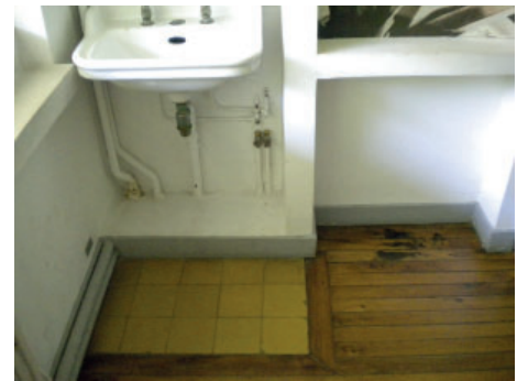
Figura 15. Recuadro de gres bajo los lavabos de planta baja de la Villa Savoye. Fotografía del autor.
