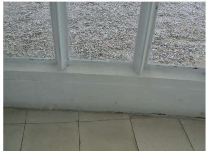
Figura 22. Estado actual del encuentro con el techo y el suelo del ventanal curvo de plata baja de la Villa Savoye. Fotografías de Jorge Ramos.
