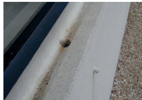
Figura 16. Detalle de la canaleta de recogida de agua bajo la ventana de planta baja en la fachada sureste de la Villa Savoye. Fotografía de Enrique Villar.
