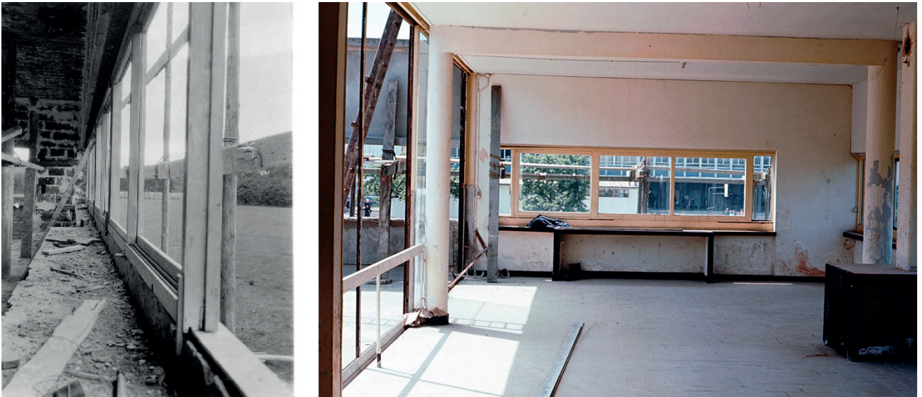
Figura 20. Fotografía de la colocación de una ventana corredera en el salón de la Villa Savoye, en septiembre de 1929. FLC L2 (17) 199. Fotografía de la ventana del salón de la Villa Savoye, en 1966. FLC, Fondo fotográfico Felix Thyes, 1966, nº 15.
